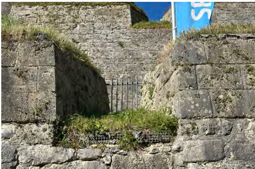
Schadhafte Lehmabdeckung auf den Kronen und den Sohlbänken der Scharten.
