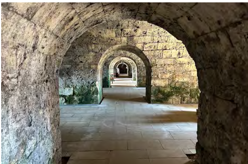
Tonnengewölbte Kasematten, Tuffquadermauerwerk, Vermoosungen und Biofilm.
