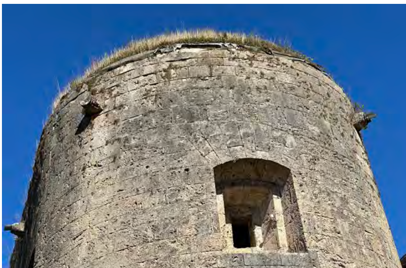
Halbrunde Eckausbildung, Wasserspeier, Lehmaufbau schadhaft, leichter Bewuchs.
