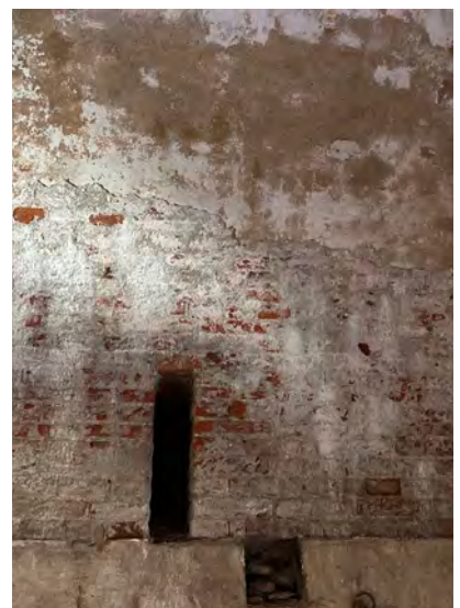
Innenräume, Putz abgewittert.
