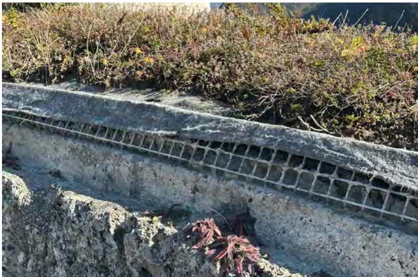
Kronendeckung schadhaft: Lehrschiicht, Metallgitter und Vlies liegen frei.
