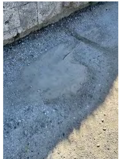
Schadhafter Estrich am Umweg.
