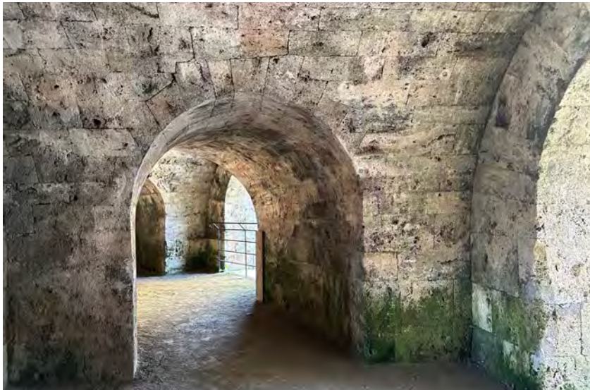
Torbau mit Bogenöffnungen, Vermoosungen und grüner Biofilm.
