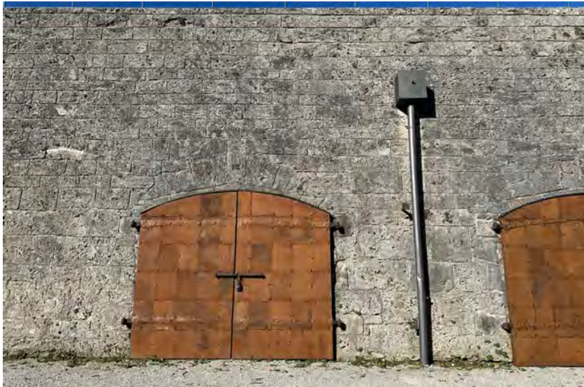
Tuffsteinmauer, verblechte Holztore, ästhetisch wenig ansprechende Regenrinne.
