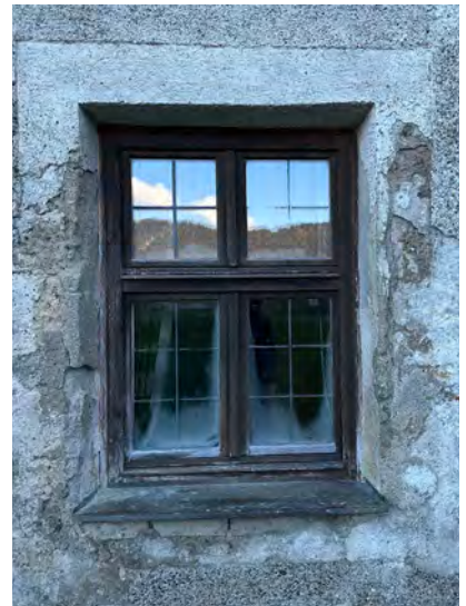
Fenster und Putzabplatzungen.
