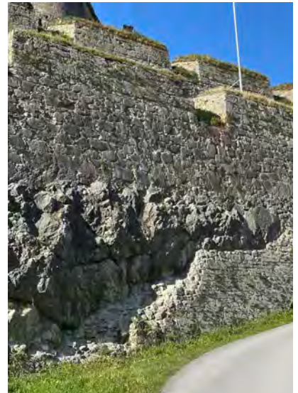
Ausbruch in der Vormauerung des Felsens.
