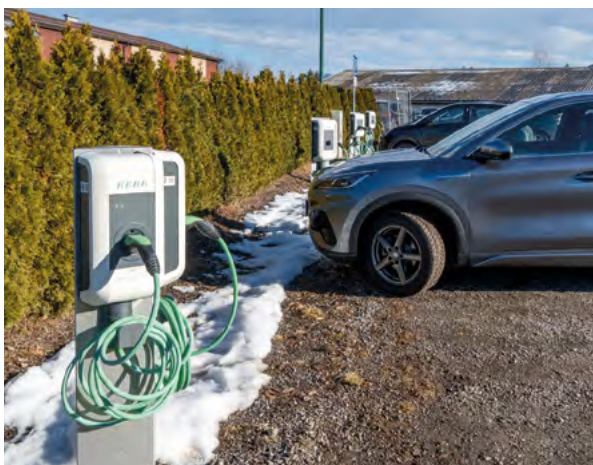
Bei Unternehmen werden E-Autos oft über mehrere nebeneinander stehende Ladesäulen versorgt.
